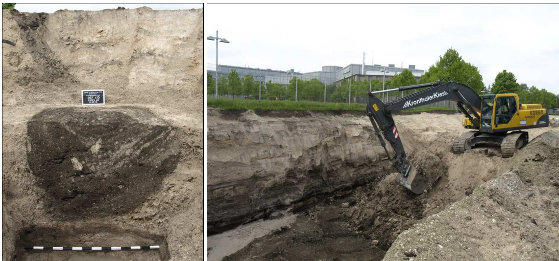
Abb. 6 Links: unteres Teilprofil des Brunnens 410. Rechts: Auskoffern der Baugrube bis zur Oberkante des Kieses.
